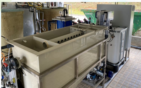
Planta piloto para estudiar la optimización de operaciones de tratamiento de agua potable
